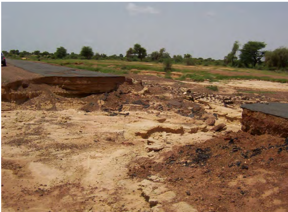
Photo 1: eau et infrastructure routière (© Gora Ndiaye)
