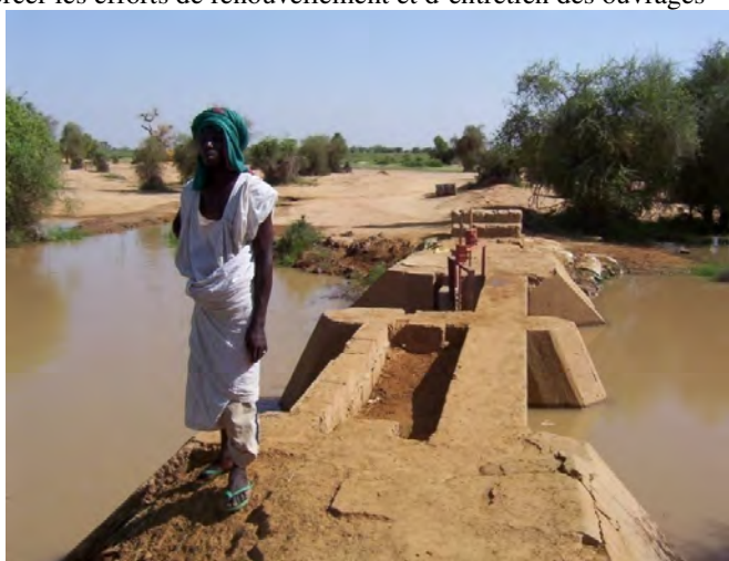
Photo 4 : Ouvrage hydraulique (© Gora Ndiaye)
